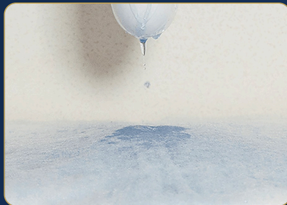
Fanger drypp ved vannlåsen
